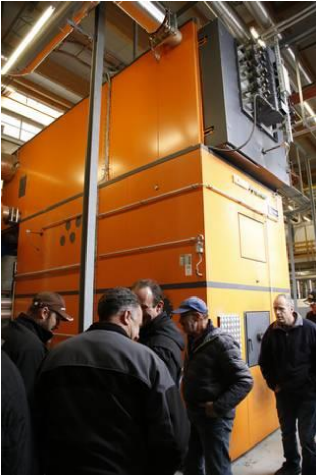
Eine Holzschmelzeheizung unterstützt die Wärmeerzeugung.
