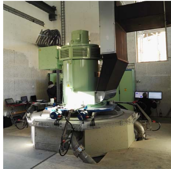
Turbinage des Torrents de Verbier (VS)
